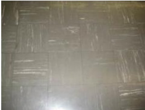
VAT – asbestos flooring
